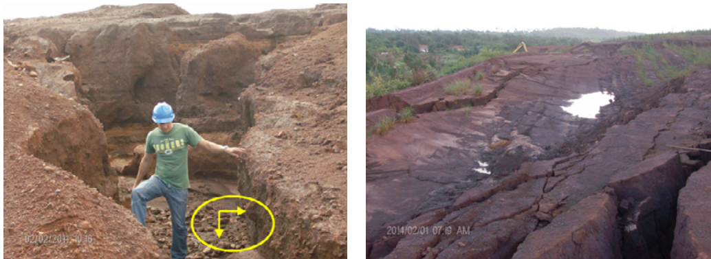
Figura 4 a). Cárcava de gran magnitud en la zona C. b) Deslizamiento en diques de la zona D
