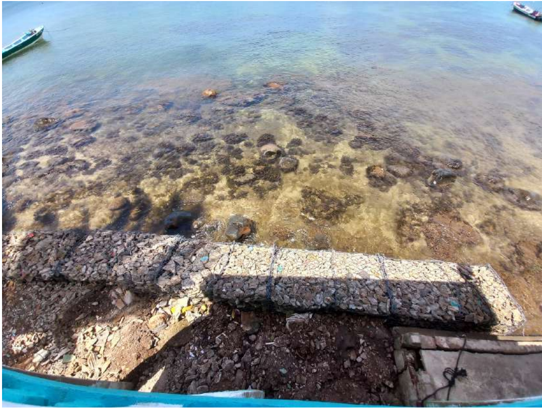
Fig. 220. Muro de contención para evitar la erosión en Little Corn Island. Fuente: Equipo de Investigación.
